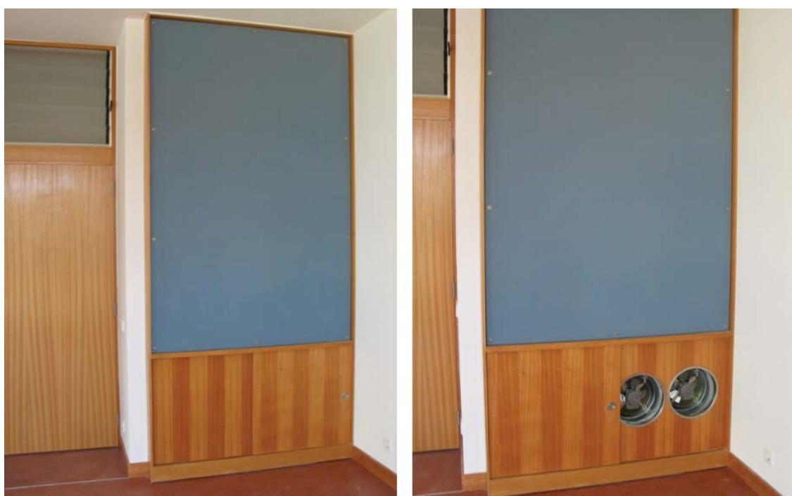
Figura 4.9 - Extremidade das condutas de ventilação e sistemas de arrefecimento pelo solo
