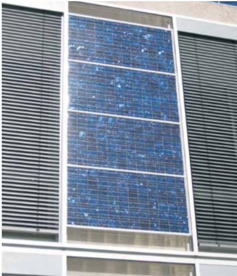
Figura 4.10 - Módulo de painéis fotovoltaicos
