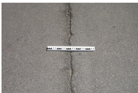
Fotografia 1 - Fenda Longitudinal ao km 105+020
