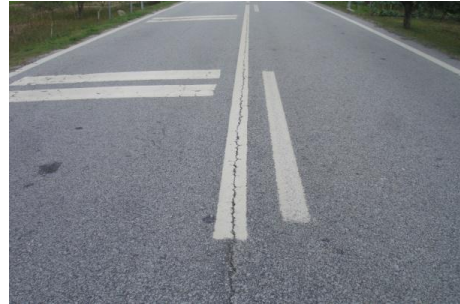
Figura 4-12: Fenda longitudinal ao km 37+720
