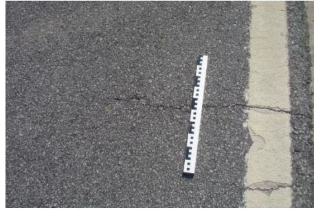
Fotografia 4 - Fenda Transversal ao km 105+090
