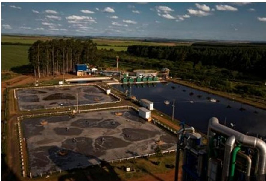
Figura 3.1 - Estação de tratamento de efluentes industriais (Anon, 2017)
