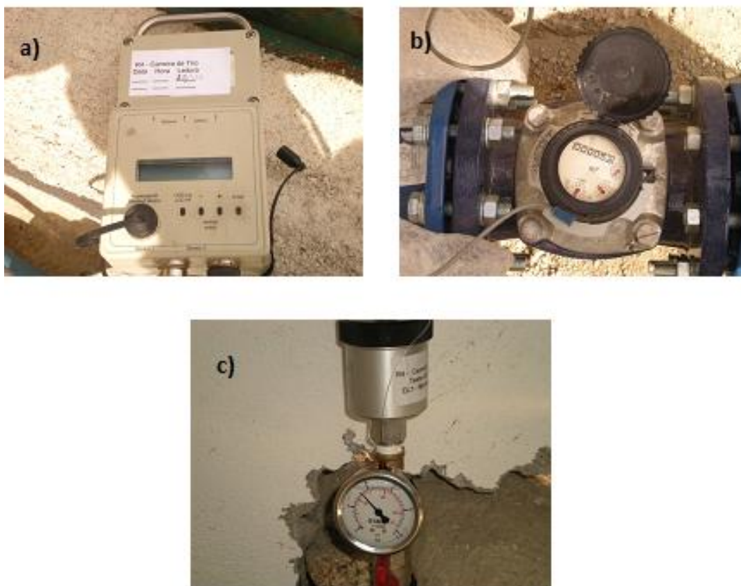
Figura 33 - Equipamento de monitorização: a) datta-logger; b) caudalímetro; c) medidor de pressão
