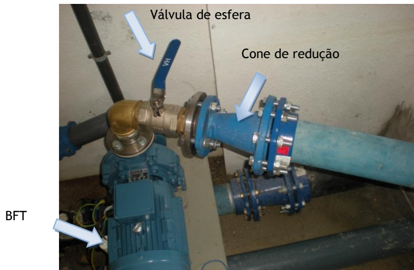
Figura 45 - Válvula de esfera para o corte de caudal à BFT
