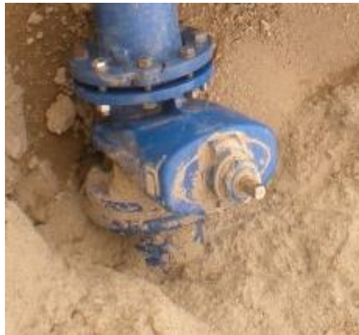
Figura 35 - Válvula redutora de pressão 3
