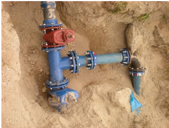
Figura 36 - By-Pass da instalação experimental
