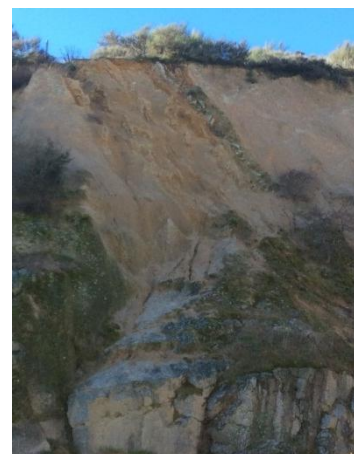
Figura A3. Exemplo de talude em solo residual de granito com a rocha-mãe visível na base.
