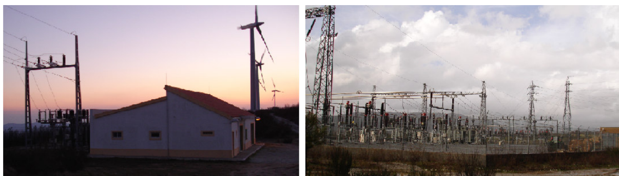
Figura 3.38 – Transformadores: a) Transformador elevador para 60 000 V; b) Transformador elevador para 220 000 V.
