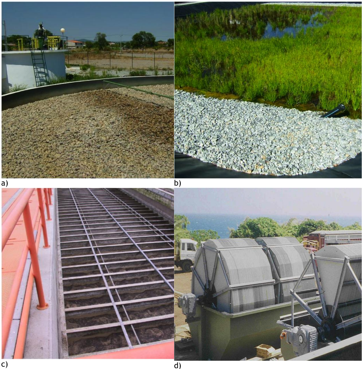
Figura 2.1. Sistemas de tratamento por filtração: a) Superfície de leito percolador (enchimento com seixo rolado); b) Entrada de leito de macrófitas (enchimento com brita); c) Superfície de um biofiltro de leito submerso (enchimento com areia); d) Discos biológicos (enchimento com poliestireno)
