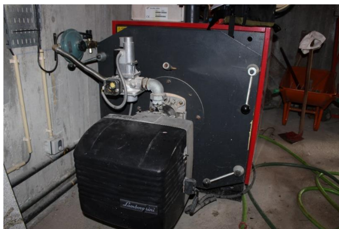
Figura 4.25 Sistema de aquecimento das águas - caldeira e queimador - edifício C.
