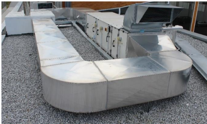
Figura 4.15 Unidade de tratamento de ar - edifício B.
