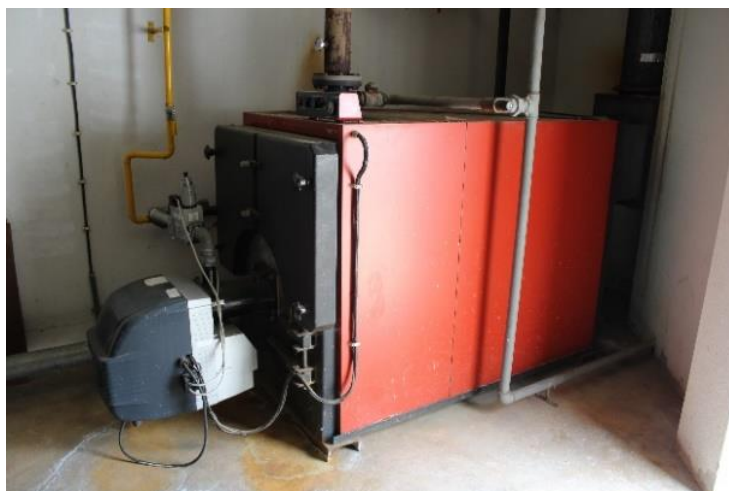
Figura 4.4 Sistema de aquecimento das águas - caldeira e queimador - edifício A.
