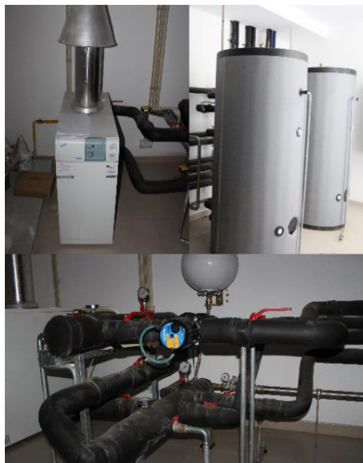
Figura 4.19 Equipamentos do sistema de caldeira - edifício B.
