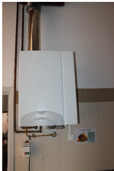
Figura 4.9 Caldeira Ferroli Domina C 30 E - edifício A.
