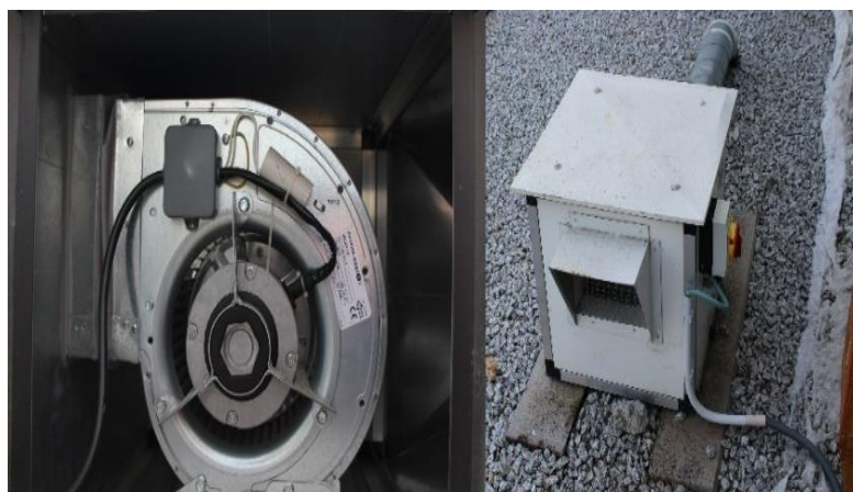
Figura 4.17 Caixa de ventilação das casas de banho - edifício B.
