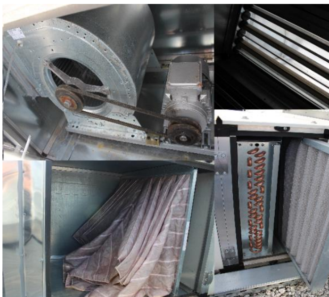
Figura 4.16 Equipamentos interiores instalados na UTA - edifício B.
