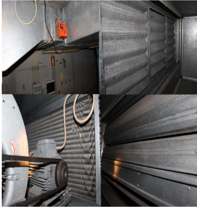
Figura 4.27 Equipamentos instalados na UTA - edifício C.
