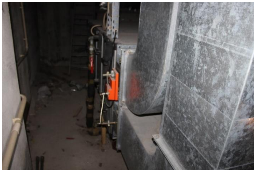
Figura 4.26 Unidade de tratamento de ar - edifício C.
