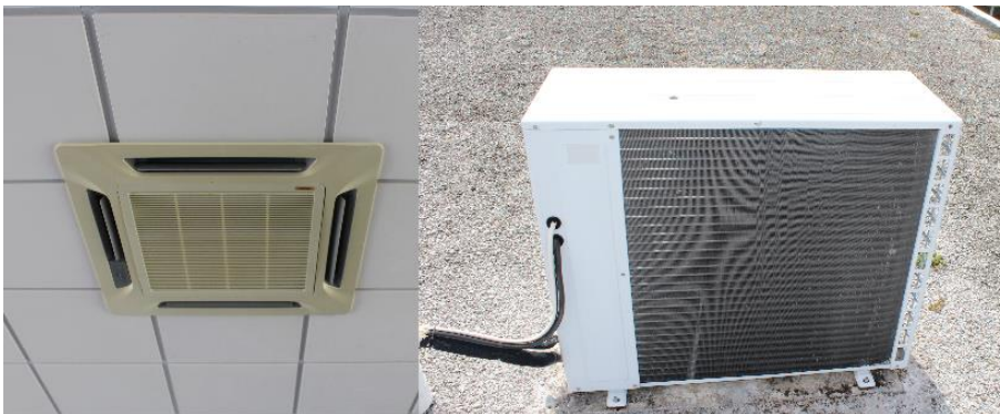
Figura 4.5 Unidade interior e exterior do equipamento de ar-condicionado.
