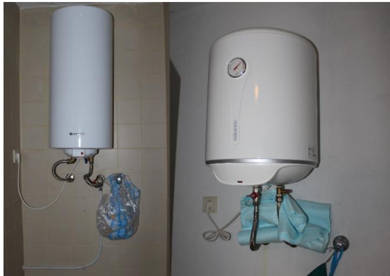
Figura 4.30 Termoacumulador Junkers e Atlantic - edifício C.
