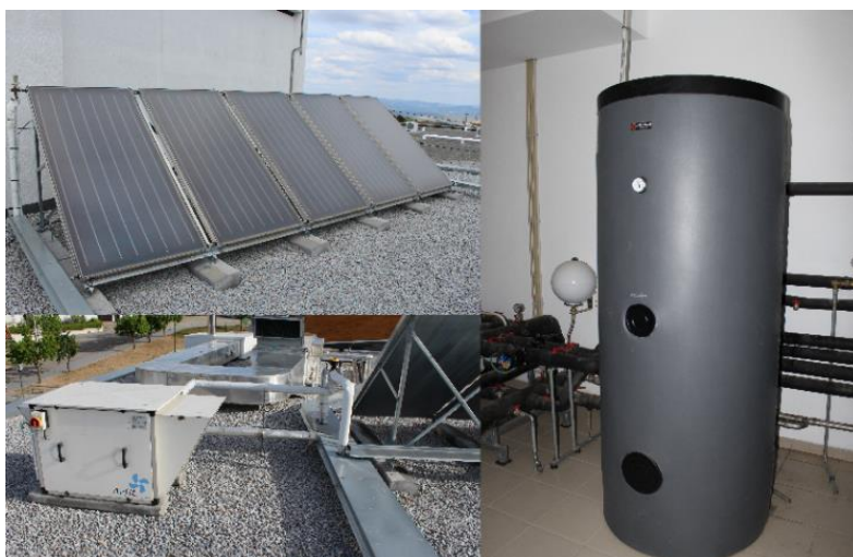
Figura 4.18 Equipamentos do sistema solar térmico - edifício B.
