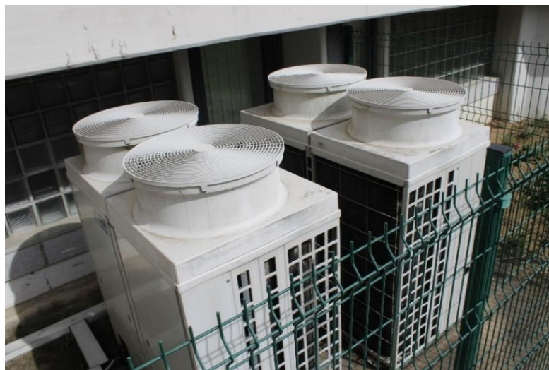
Figura 4.28 Unidade exterior do sistema de VRV - edifício C.
