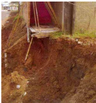
Figura 2.54 - Descalçamento das fundações da estrutura devido a escavações próximas (Schnaid, 2006)
