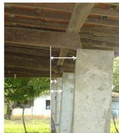
Figura 2.10 - Inclinação de pilares devido a expansão do solo de fundação - Município de Santo Amaro (Cavalcante et al. , 2006)
