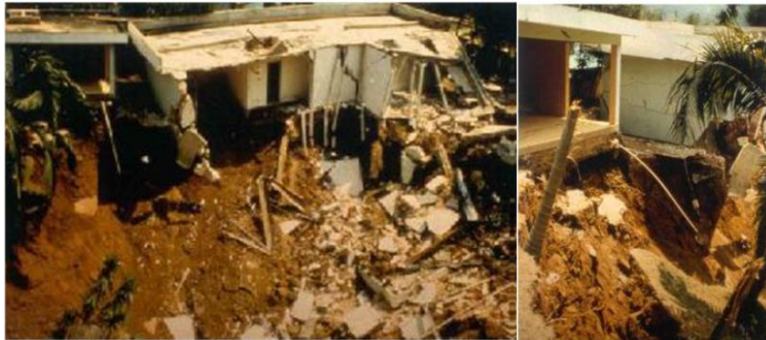
Figuras 2.17 - Imagens das consequências do colapso do solo - Município de Sete Lagoas (Modificado, Universidade Estadual Paulista "Júlio de Mesquita Filho" in Carvalho, 2010)
