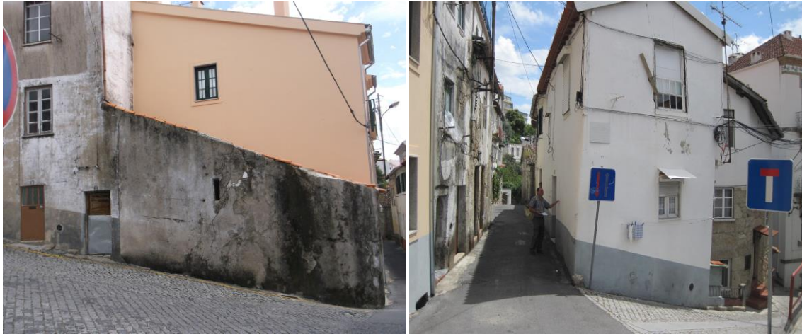
Figura 3.23 - Imagens de casas que evidenciam (por apresentar as paredes desalinhas da vertical) consideráveis patologias na zona em análise (a), Largo Eduardo Malta
