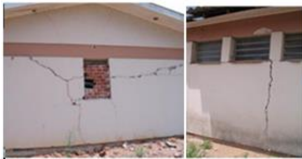
Figuras 2.6 - Exemplos de danos provocados devido à variação volumétrica do solo (Carvalho, 2010)
