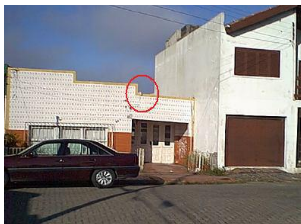
Figura 2.51 - Problemas causados pela construção de novas estruturas vizinhas sem junta de separação (Schnaid, 2006)
