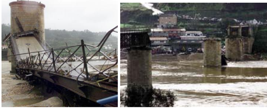
Figura 2.60 - Ponte de Entre-os-Rios em ruína devido essencialmente à erosão nos seus pilares (TVI24)
