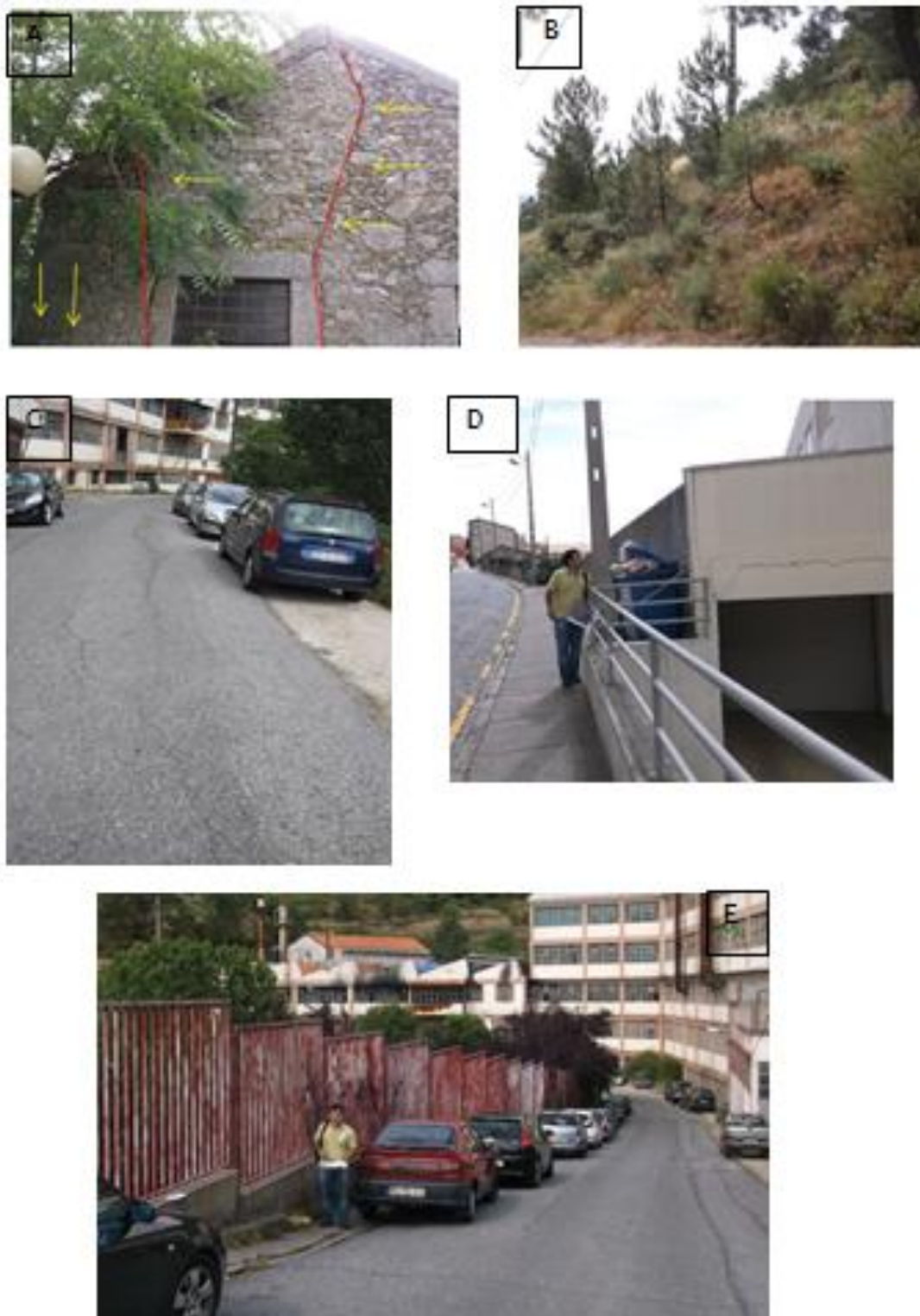
Figura 3.37 - Imagens sobre deformações no pavimento e em edifícios, evidenciando superfícies potências de rutura e deformações Patológicas observadas: edifício próximo ao DECA (A ponto a ), Travessa da Fonte Santa (B ponto b ) Rua por cima do Silo das Engenharias (C ponto c , E ponto d ), e Rua Marquês de Pombal (D ponto e )
