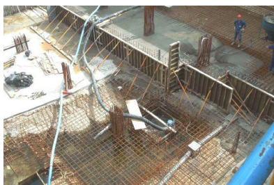
Figura 2.39 - Abaixamento do nível freático com ajuda de bombas durante a betonagem (Carvalho,2010)
