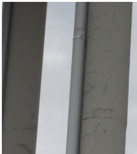
Figura 3.19 - Malha de fissuração dos pilares ponto a - Biblioteca Municipal
