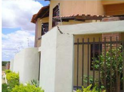
Figura 2.9 - Rutura de um pórtico causada por expansão de solos - Município de Poço Verde (Cavalcante et al. , 2006)
