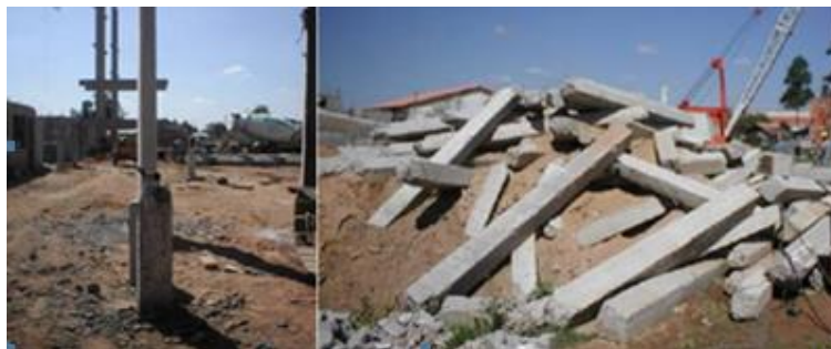
Figura 2.43 - Imagens que evidenciam o excesso de energia de cravação, com graves danos estruturais nas estacas (Schnaid et al. , 2005, in Carvalho, 2010)
