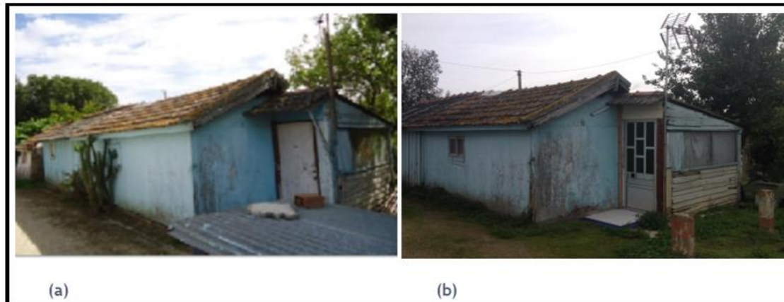
Figura 41 - Edifício com piorias ao nível do EC, (a) edifício “PAL_2A” em 2014 (Almeida, F., 2014: DECMaVi); (b) edifício “PAL_2A_16” na análise atual.
