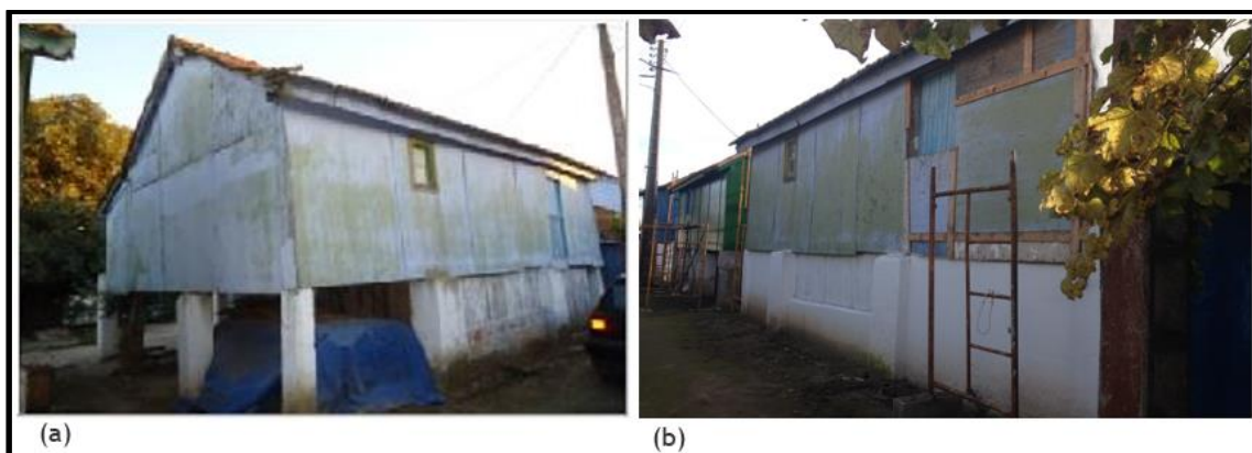
Figura 73 - Edifício com descida de nível da MA, (a) edifício “PAL_8” em 2014 (Almeida, F., 2014: DECMavi); (b) edifício “PAL_8_16” na análise atual.
