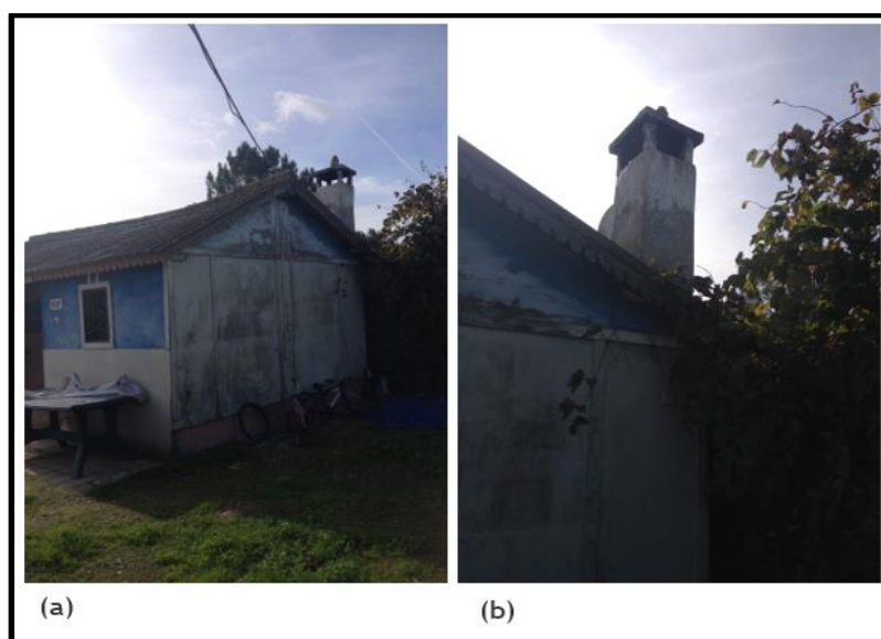
Figura 28 - Edifício com agravamento do EC, (a) paredes exteriores do edifício “PAL_10A_16” na análise atual; (b) chaminé do edifício “PAL_10A_16” na análise atual.
