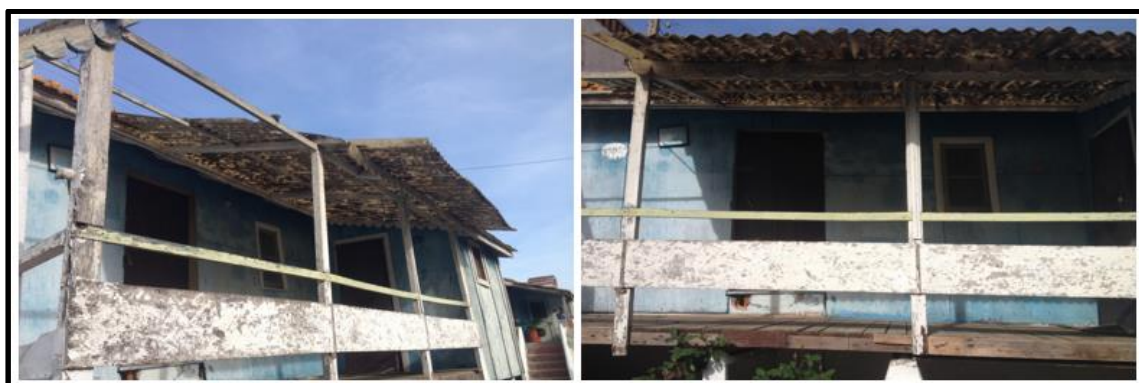
Figura 35- Edifício com agravamento do EC, apêndice do edifício “PAL_10_16” na análise atual.
