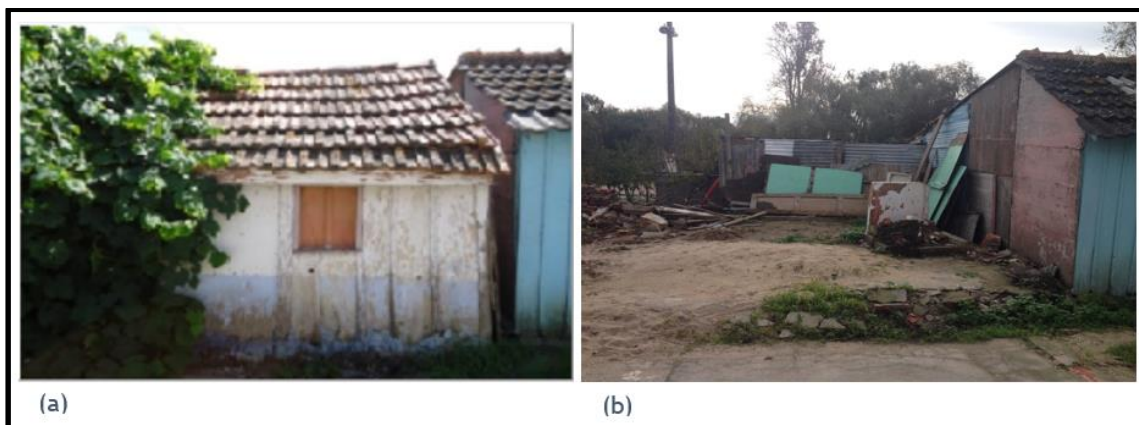
Figura 25 - Edifício desaparecido, (a) edifício “PAL_3” em 2014 (Almeida, F., 2014: DECMaVi); (b) edifício “PAL_3_16” na análise atual.
