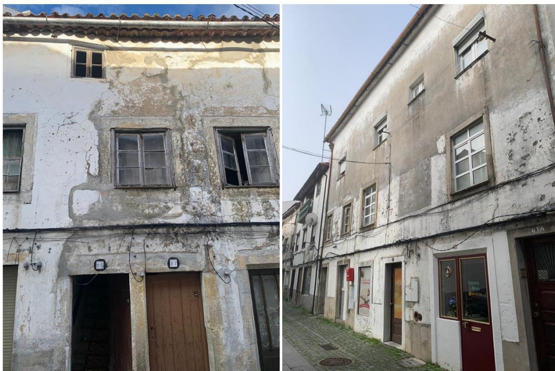
67. Fotografias do estado das fachadas pré-intervenção do projeto (Autor,2023)
