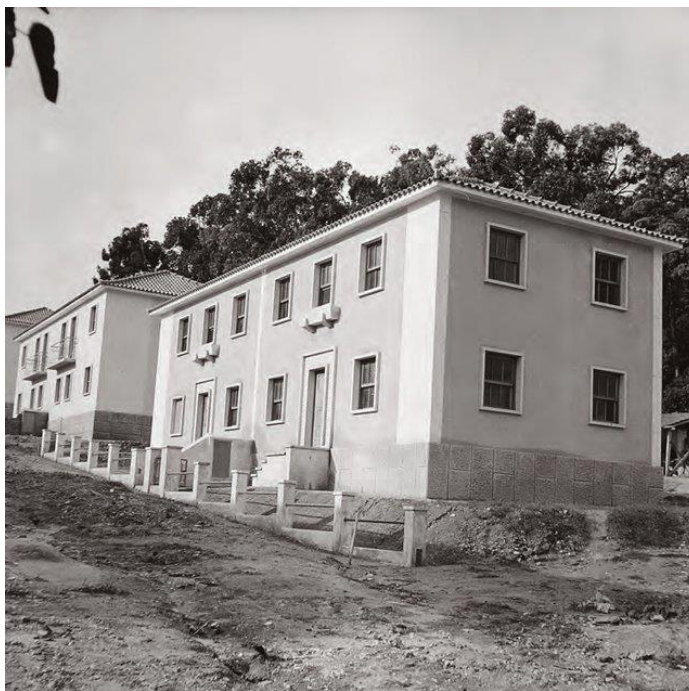
12. Bairro do Benfica em construção, Lisboa. Acompanhada de uma estética burguesa, as habitações possuíam um confortável e espaçoso programa em seu interior. (SIPA / DGEMN, 1958)
