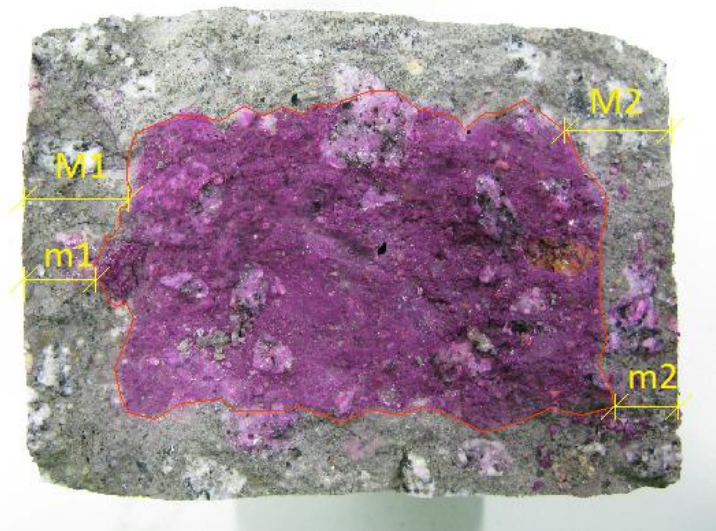
Figura 5.4 - Medidas da profundidade de carbonatação.
