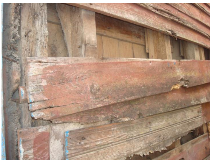
Fig. 61: Estrutura com vigas verticais (prumos) e escoras. Note-se o igual espaçamento entre as vigas verticais.
