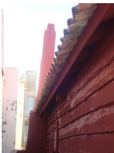
Fig. 101: Beiral tipo 2. Embora a telha utilizada não seja a telha marseilha, a execução deste não sofre alteração.
