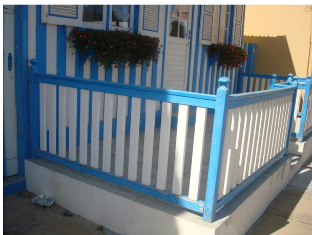
Fig. 74: Palheiro sobre embasamento, no qual estão presente os degraus de adobe rebocados.
