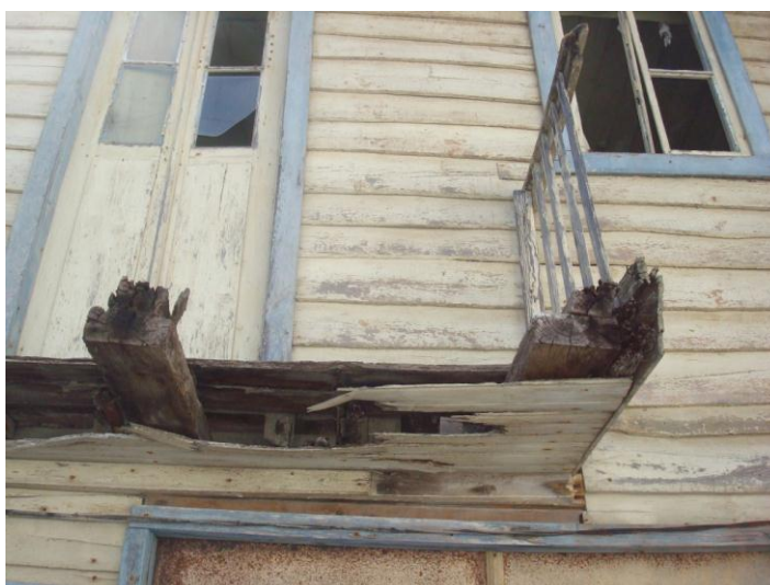
Fig. 72: Elementos estruturais expostos dada a degradação da varanda.
