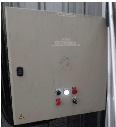
Figura 54 – Representação do quadro elétrico com a luz de tensão ligada sem a sinalização adequada.
