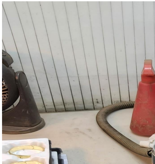
Figura 37 – Exemplo de sujidade nas paredes do setor produtivo.
