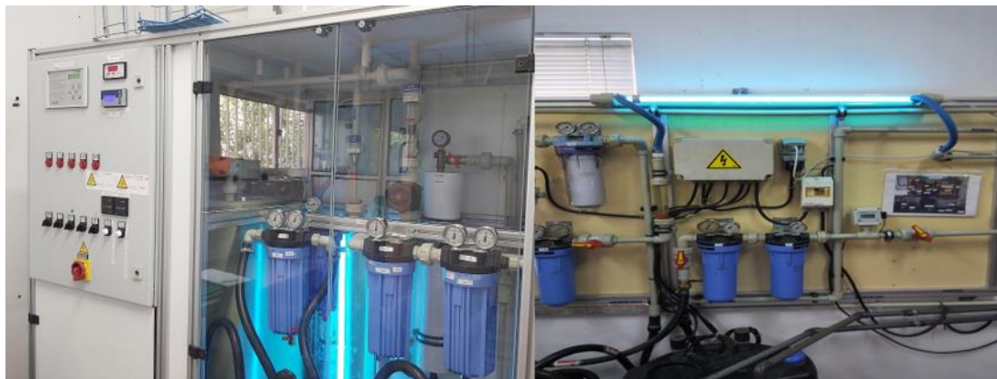
Figura 46 – Presença de duas fontes de luz UV totalmente expostas aos trabalhadores.
