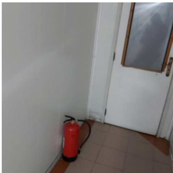
Figura 52 – Representação de extintor em corredor de circulação e evacuação, fora do suporte e respetiva identificação.
