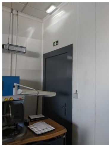
Figura 60 – Representação da saída de emergência falsa e com reduzido acesso.
