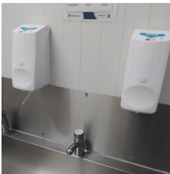
Figura 51 – Dispensadores de sabão de lavagem vazios em ambas as zonas das instalações sanitárias.
