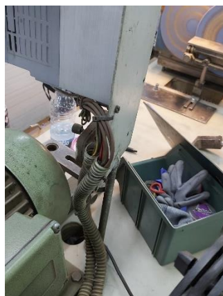
Figura 42 – Representação do perigo de cabos elétricos num equipamento da zona de preparação.
