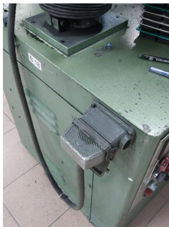
Figura 44 – Presença de uma fonte de alimentação de um motor elétrico junto ao corredor de circulação lateral das Bulas.
