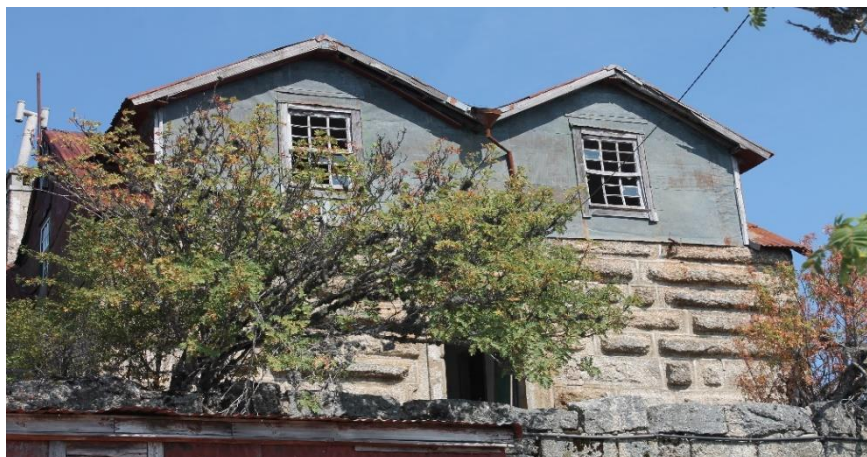
Figura 135 - Degradação Casa do Guarda
