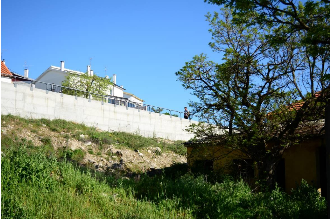
Figura 24-Relação estabelecida do muro de betão com o existente e a envolvente (do autor)
