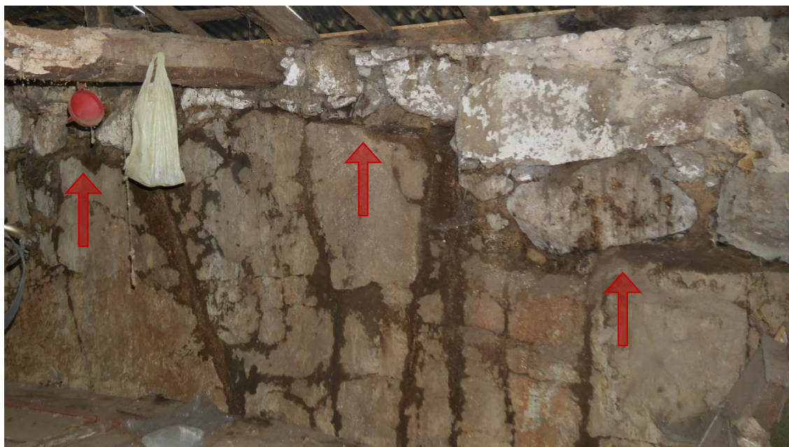
Figura 10 - Foto com identificação do limite da rocha maciça com alvenaria de pedra
