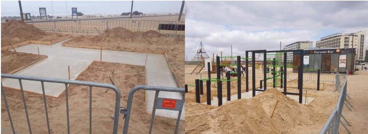
Fig. 1.6 - Implantação de um street workout na zona marginal de praia da Costa da Caparica. Na imagem esquerda vê-se a construção do maciço de betão e imagem direita a montagem do equipamento que é fixo à base de betão por ligação mecânica e bucha química.
