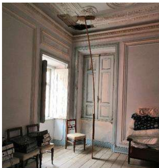
Figura 28. Elevado estado de degradação do Estabelecimento Termal.
