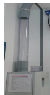
Figura 8 - Sistema de Tubo Pneumático (vácuo) para distribuição de medicamentos urgentes
