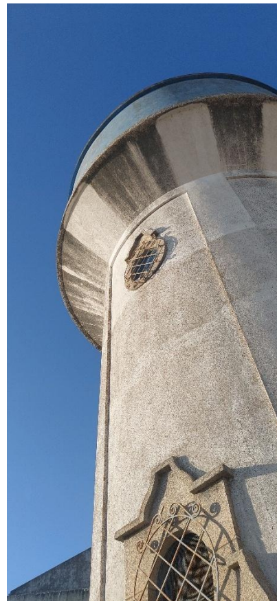
Figura 49: Reservatório elevado de Ruvina, Ruivós e Vale das Éguas Fonte: O autor
