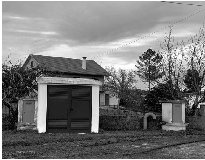
Figura 17: Elementos de válvulas, posto de rechloragem e respiro Fonte: O autor Cardeal, Sabugal
