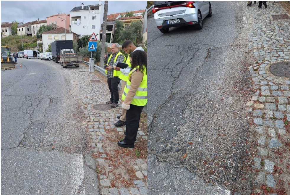
Figura 5.9: Verificação “in situ” da identificação e nível de gravidade das degradações desagregação superficial do mástique e reparações, com recurso a inspeção visual a pé.
