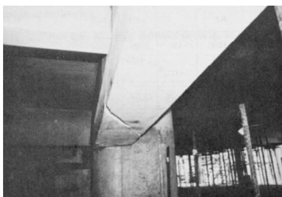
Figura 1.3. Fissura helicoidal devido à torção [9]
