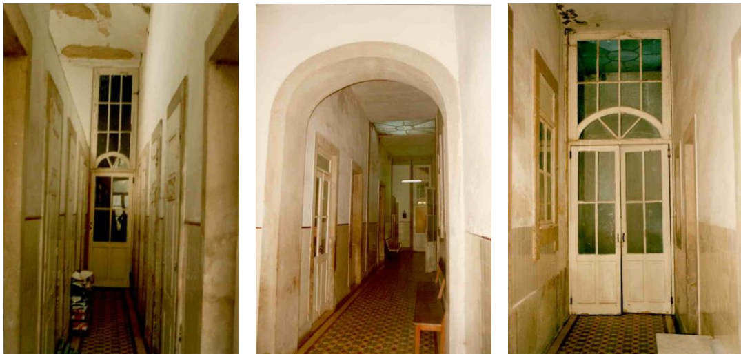
Figura 4.49 - Corredores do balneário Rainha D. Amélia com acentuada degradação na década de 90 (CMSPSul, 1998a).
