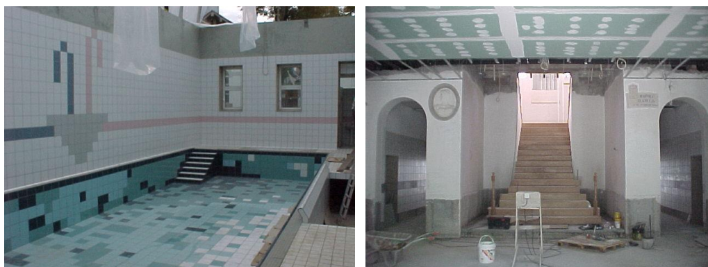
Figura 4.50 - Obras de remodelação, alteração e ampliação do balneário Rainha D. Amélia na década de 90 (CMSPSul, 1999).
