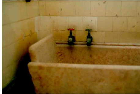
Figura 4.48 - Banheiras em mármore encastradas no pavimento no Balneário Rainha D. Amélia (CMSPSul, 1998).
