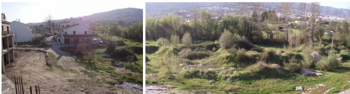
Imagem 42 – Áreas de cedência no loteamento nº 21, sem a conclusão das infra-estruturas viárias e espaços colectivos
