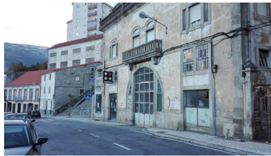
Ilustração 31 - Prédio degradado na lateral do elevador de Santo André (Covilhã).
