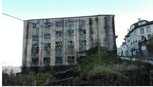
Ilustração 42 - Fachada posterior da Garagem de São João, um imponente prédio comercial em lamentável estado de degradação.
