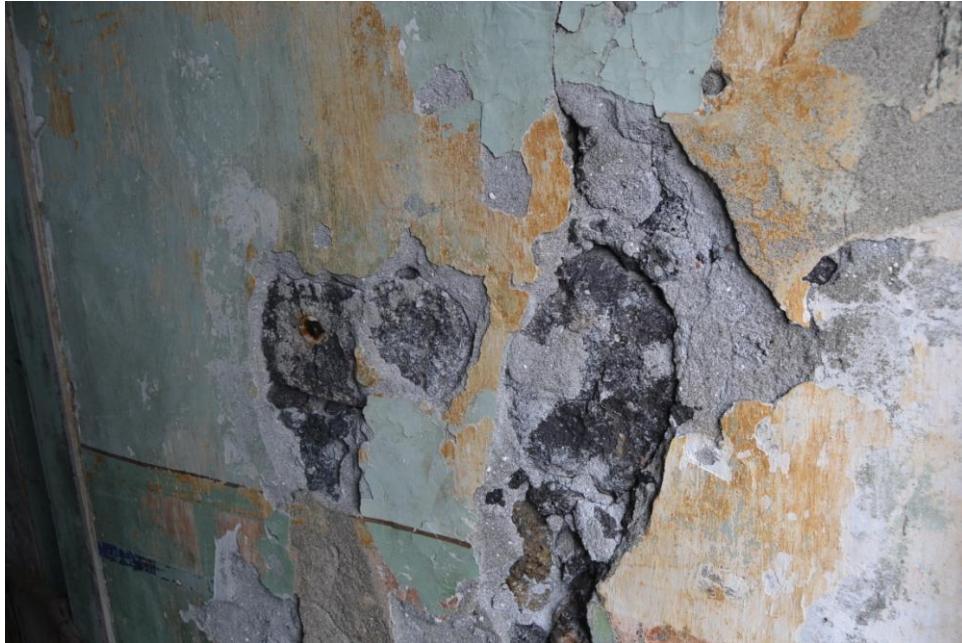
Ilustração 17. Alvenaria de pedra interior rebocada a barro e cal com evidentes problemas de degradação
