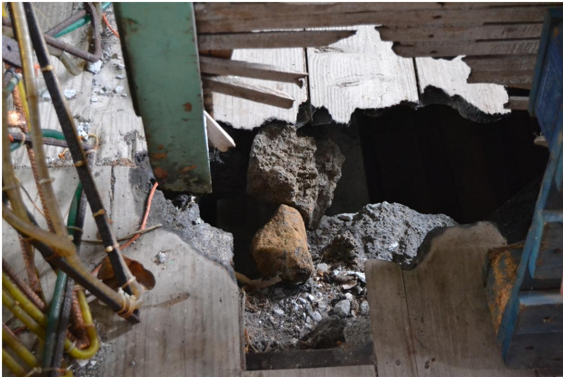
Ilustração 16. Degradação da parede divisória, do soalho e da parede "mestra"
