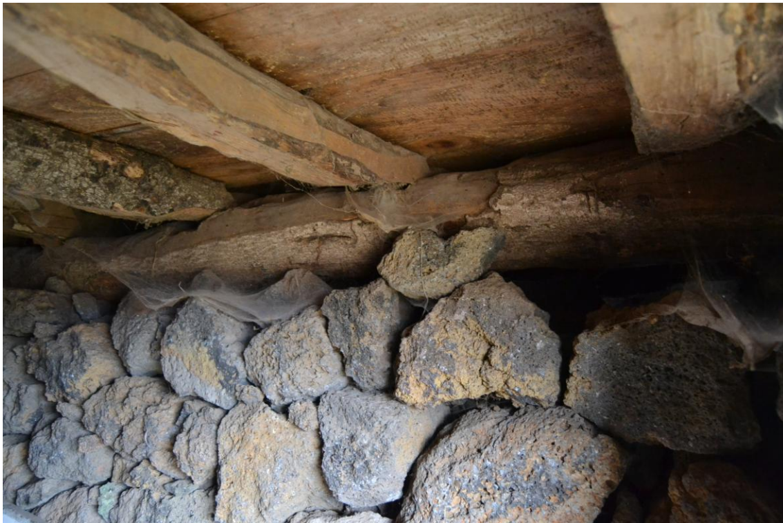
Ilustração 28. Parede Mestra do Piso 0, evidente degradação e falha estrutural
