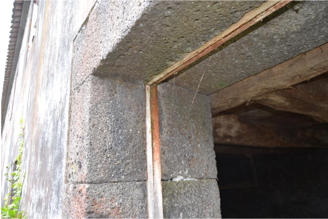
Ilustração 27. Vão de porta em cantaria, porta inexistente
