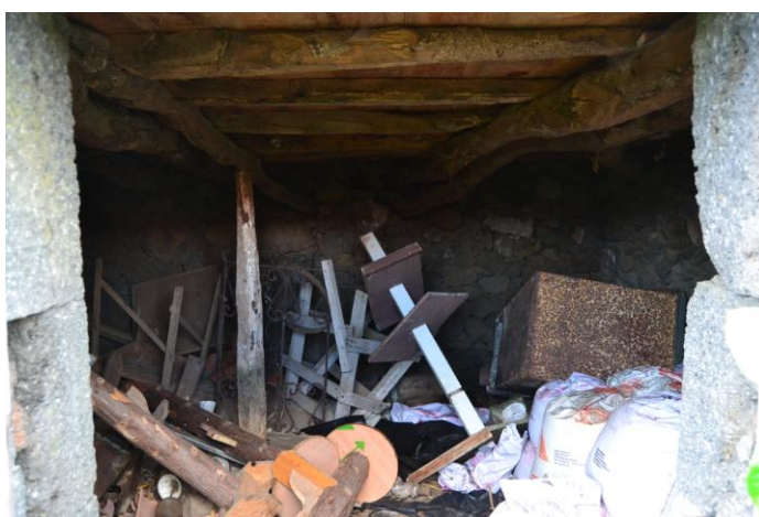
Ilustração 35. Estado de conservação do piso térreo, soalhos em mau estado
