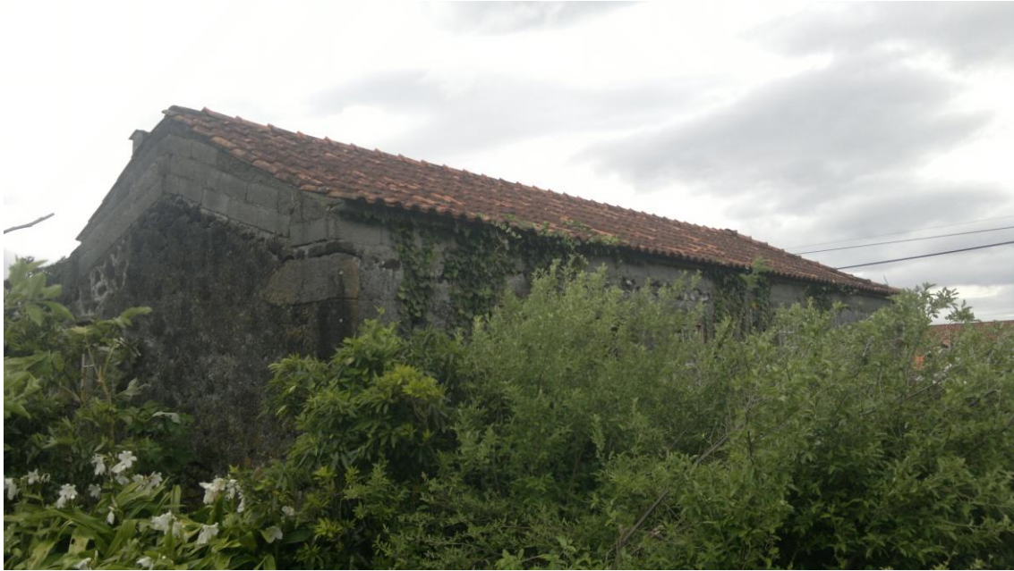
Ilustração 31. Vegetação envolvendo o edifício, contribuindo para a degradação
