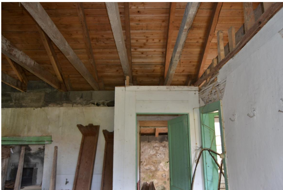
Ilustração 24. Interior do Passal com evidentes marcas de degradação
