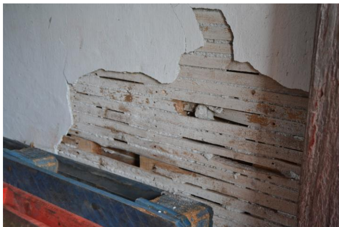
Ilustração 34. Falhas evidentes nas divisórias em tabique
