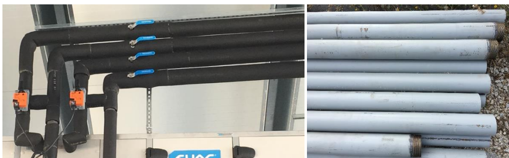
Figura 31 - A imagem da esquerda com tubagens isoladas e válvulas; Imagem da direita com tubagem pintada.
