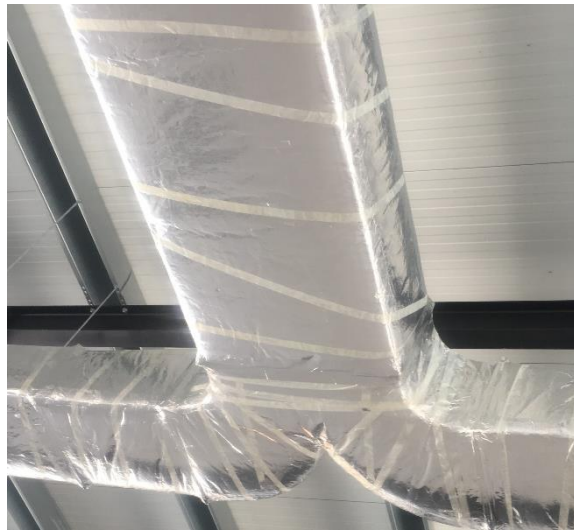
Figura 30 - Conduto isolada e reforçada com fita nylon.
