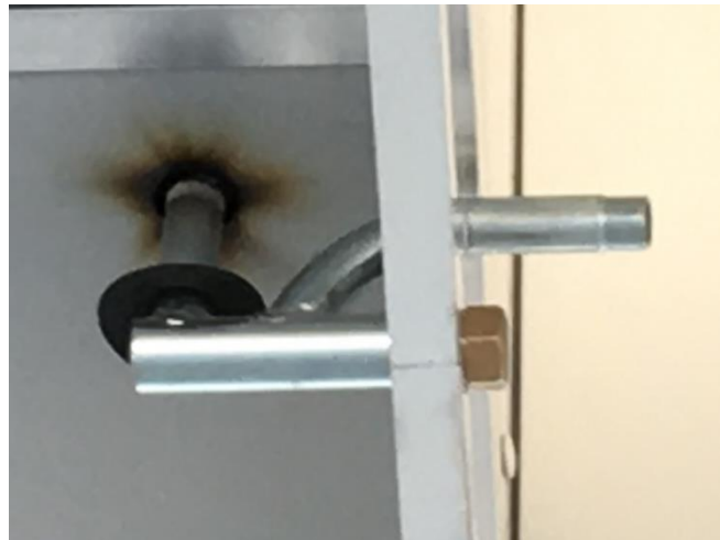
Figura 34 - Sifão das UTAs.
