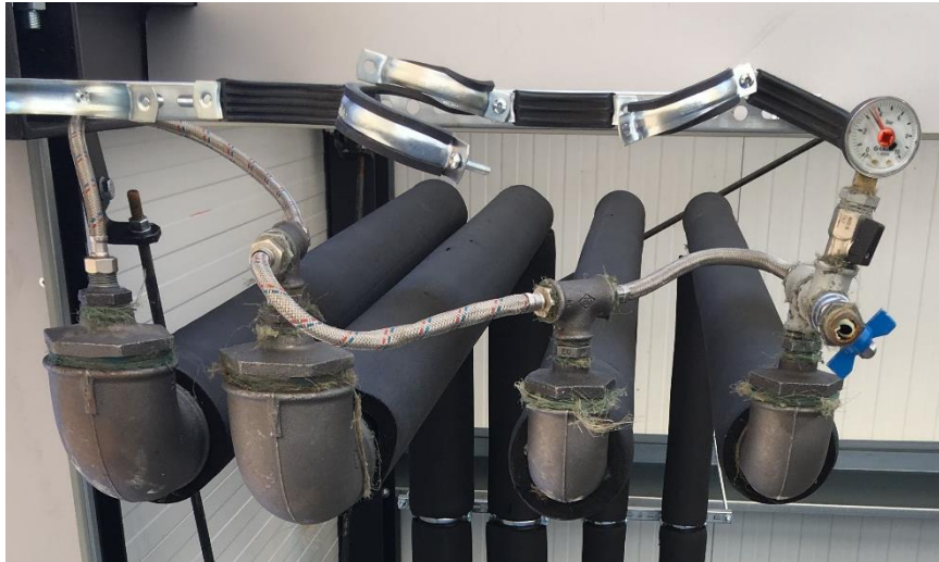
Figura 33 - Tubagem à carga com manómetro a marcar 3,5bar.
