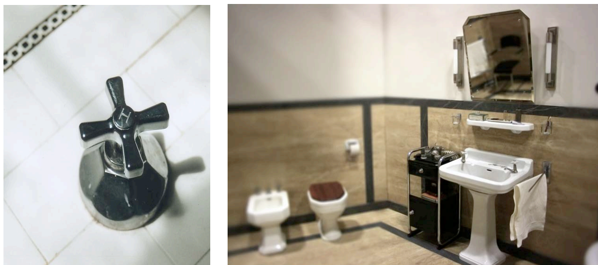
Fig. 11 - a) e b) Instalação sanitária: zona de tratamento higiénico
