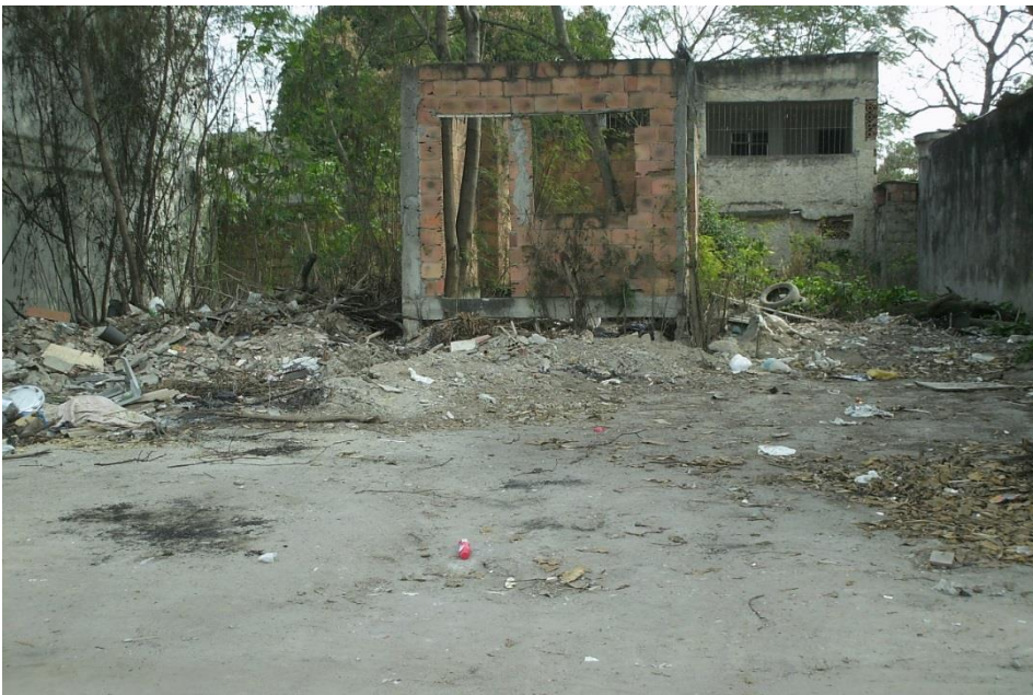
Figura 108 - Obras abandonadas e lixo acumulado
