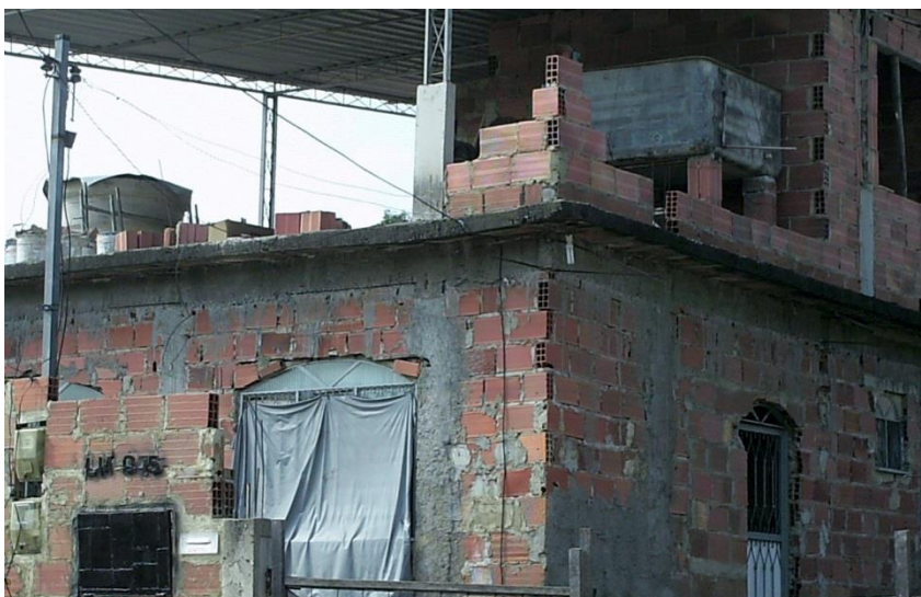
Figura 98 - Cobertura metálica aparentemente provisória
