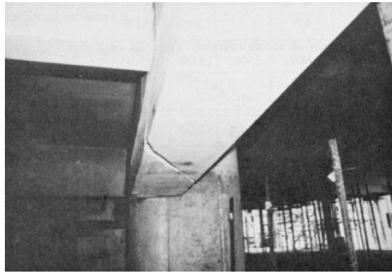
Figura I.4 - Rotura frágil por torção de uma viga num edifício [31]
