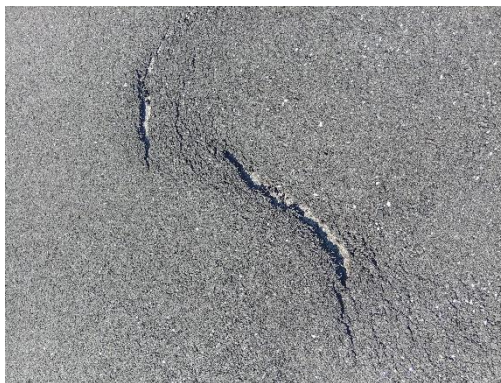
Figura 11 – Ondulação no pavimento
