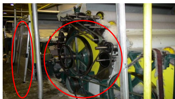
b) Elementos móveis rotativos desprotegidos.
