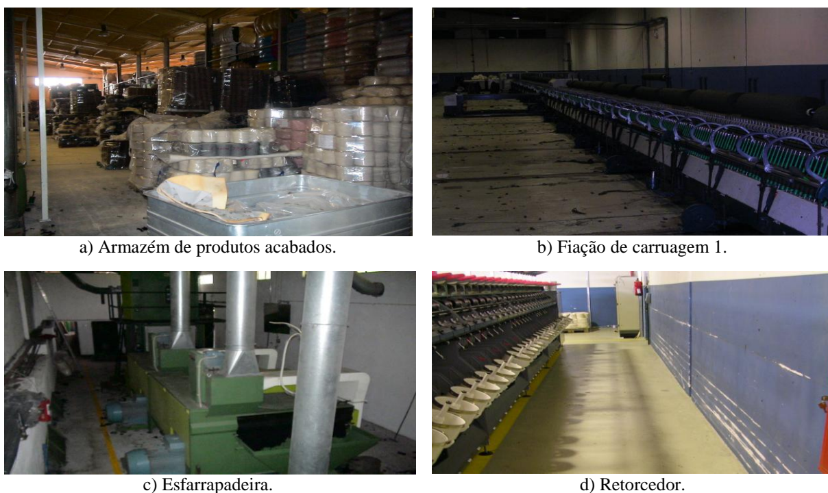
Figura 4.44. Registo fotográfico dos níveis inadequados de iluminação nas diferentes secções.
