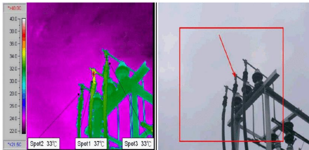
Figura 14 – Análise termográfica em componentes eléctricos [64]
