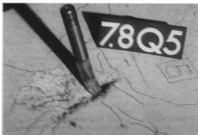
Figura 11 - Deformação de ancoragens por corte e destacamento superficial de betão (CEB [2])
