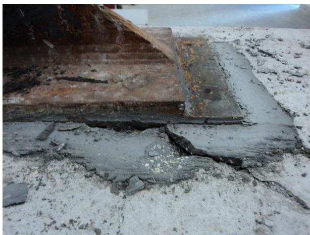
Figura 75 - Rotura secundária da ligação
