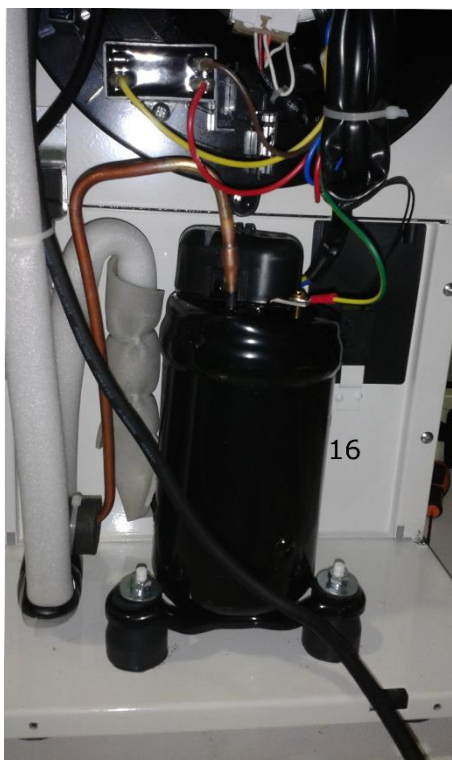
Figura 5.6- Localização do compressor (16).
