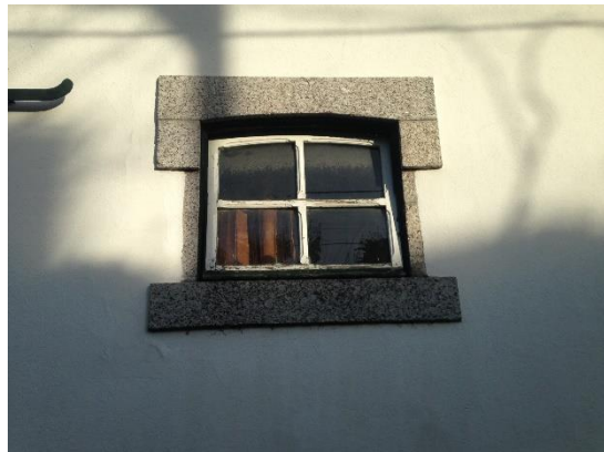
Imagem 54| Janela do armazém da estação de Vila Caiz, outubro 2017
