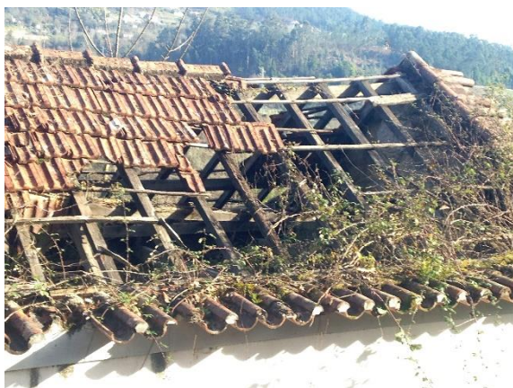
Imagem 39| Cobertura com estrutura à vista da Estação de Fregim-A, fevereiro 2017
