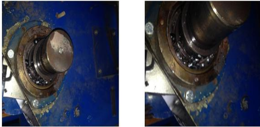
Rolamento interior, totalmente danificado
