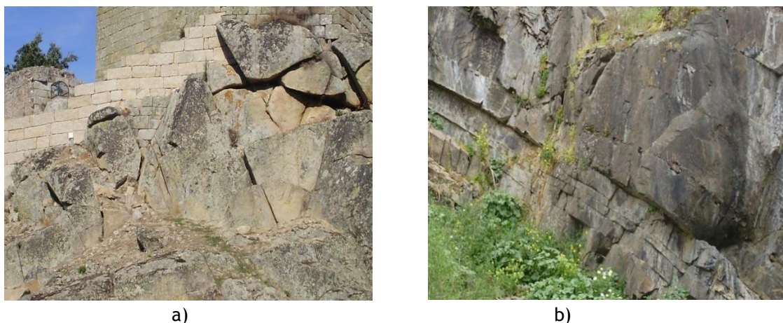
Figura 2.14 - Exemplos de espaçamentos de diaclases em afloramentos. a) Maciço rochoso de boa qualidade com diaclases diagonais com espaçamentos na ordem de 0,5 - 1,5 m (maciço Castelo de Marialva); b) Maciço rochoso com família de diaclases na diagonal com continuidade alta e espaçamento moderado (Mértola).
