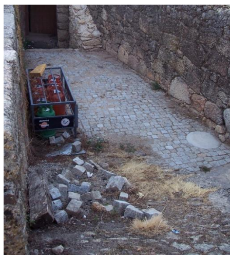
Figura 98 | Degradação do pavimento, Monsanto, Fonte: Marília Ramos
