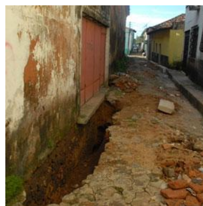
Figura 40 | Rua degradada, Fonte:
