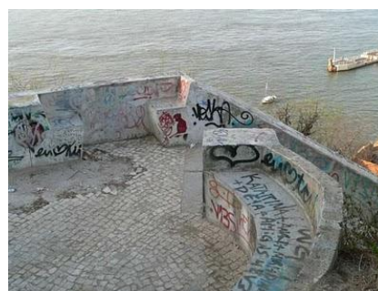
Figura 41 | Degradação mobiliário urbano,
